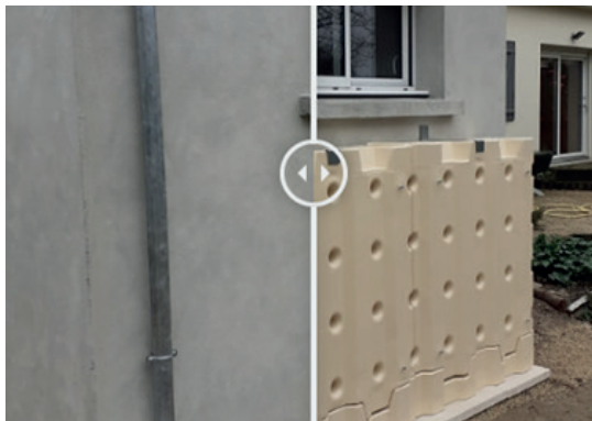
Maison individuelle équipée de collecteurs de 600 litres pièce installés en série Grenoble (38)
